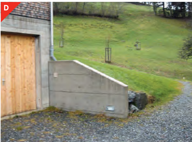
Abb. 22: Die an sich kleine Flügelmauer ist hier immer noch zu hoch ausgefallen, auch hätte auf die zusätzlichen Steine rechts der Mauer verzichtet werden können.
