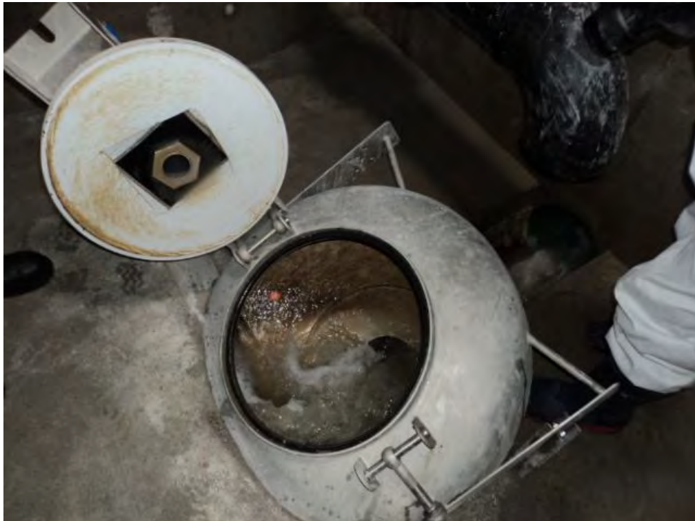
Abb.: Drossel des Wirbelabscheiders Schwimmbad, Heiden
