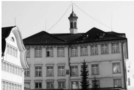
Restaurierter Dachreiter mit Blitzschutz nach dem Umbau 2002. Projekt Arch. Büro Thomas F. Peterer
