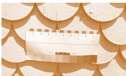
Untersuchung eines Farbanstrichs auf mögliche Schadquellen.
