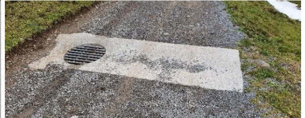
Breite Betonschale mit Schacht zur unterirdischen Ableitung grösserer Wassermengen, die talseitige Böschung wird damit vom Wasserabfluss entlastet.
