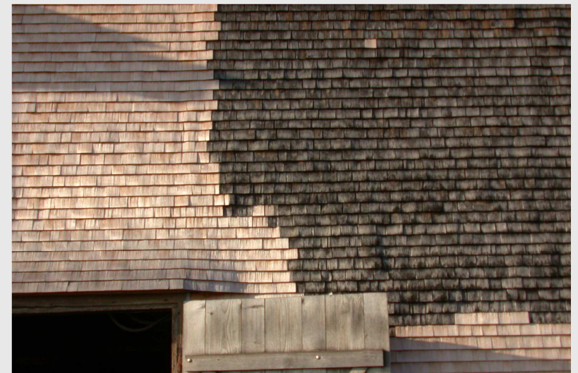
Restaurierte Schindelfassade gegen Nordosten an einem Tätschdachhaus aus dem Jahre 1576 auf Vögelinsegg in Speicher
